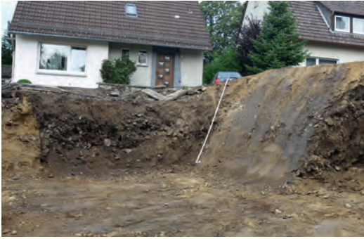
Abb. 13: Blick auf die Baugrubenwand an der Eresburger Straße 63. Deutlich erkennbar sind die mit Schutt verfüllten neuzeitlichen Bodeneingriffe. Eine Bebauung dieses direkt westlich des Friedhofs von Obermarsberg gelegenen Grundstücks war aus den Altkarten nicht zu entnehmen (Foto: LWL-Archäologie für Westfalen/E. Cichy).
