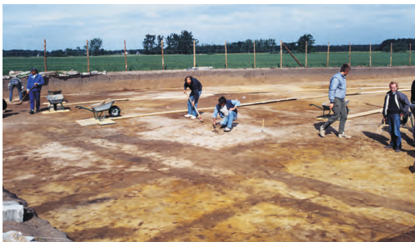
Abb. 14: Grabung innerhalb des Prätoriums. Die im hellen Sand sichtbaren dunklen Verfärbungen gehen auf die Fundamentierungsarbeiten für das Gebäude zurück (Foto: J.-D. Ludwig, LWL-Archäologie für Westfalen).
